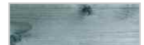
Unbehandelte Oberfläche Folge: Holz vergraut vollflächig
