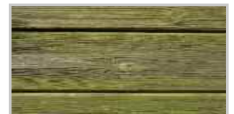
Holzoberfläche VOR der Bearbeitung mit Grünbelag-Entferner
