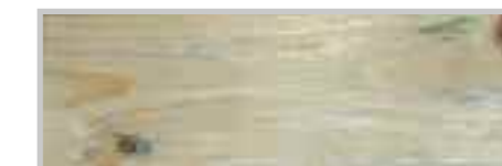
Herkömmliche farblose Lasur ohne UV-Schutz Folge: Irreparable Vergrauung und/oder Bläueschäden
